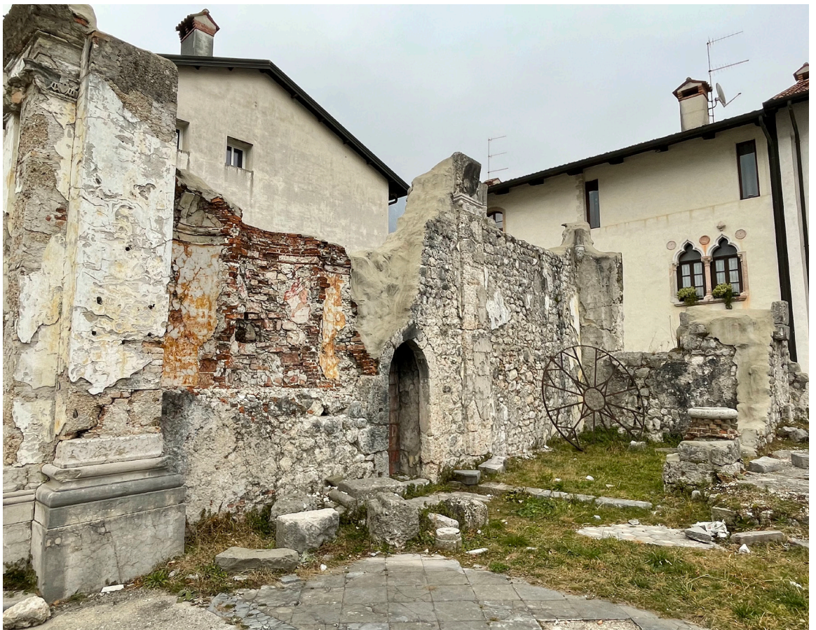
Abb. 4: Venzone, teilgesicherte Ruine und stark gefährdete Architekturoberflächen der Kirche San Giovanni Battista (21.02.2023).
