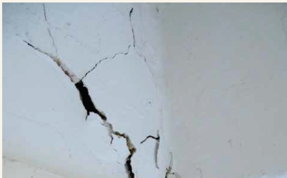
Rissebildung mit Feinstaubentwicklung infolge der missglückten Geothermiebohrung in Staufen gefährden das Archivgut der Außenstelle, 2020. Inv. Nr. BA 2020/3-4
