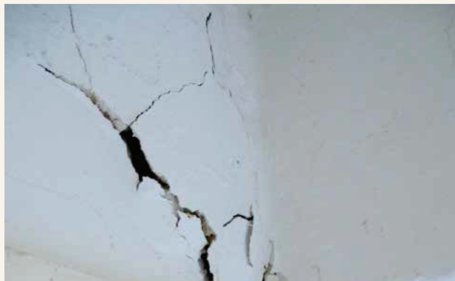
Rissebildung mit Feinstaubentwicklung infolge der missglückten Geothermiebohrung in Staufen gefährden das Archivgut der Außenstelle, 2020. Inv. Nr. BA 2020/3-4
