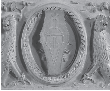
Abbildung 120: Bernhardinmausoleum, Schäden Ornament vorderseitige Sockel- zone
